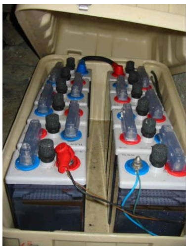
Batteries OPzS 450 Ah (installées en 2012)
