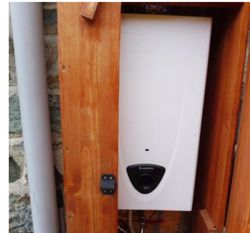
Chauffe-eau cuisine (placard extérieur)
