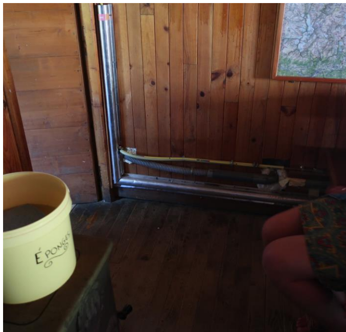
Conduite gaz + alimentation eau cuisine (à reprendre)
