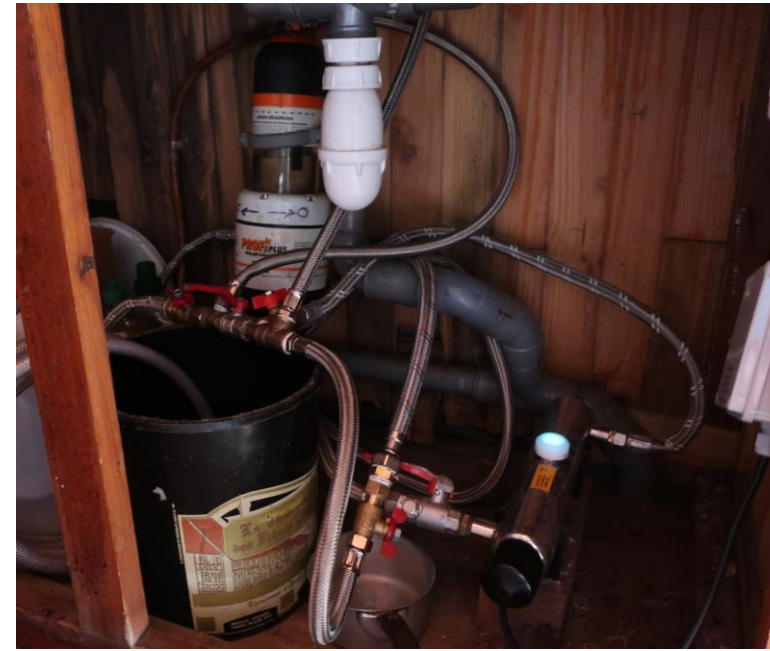
Actuel filtre + traitement UV à déposer (dans placard coin hors-sac)
